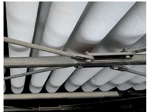
Heißgasfilterelemente im eingebauten Zustand
