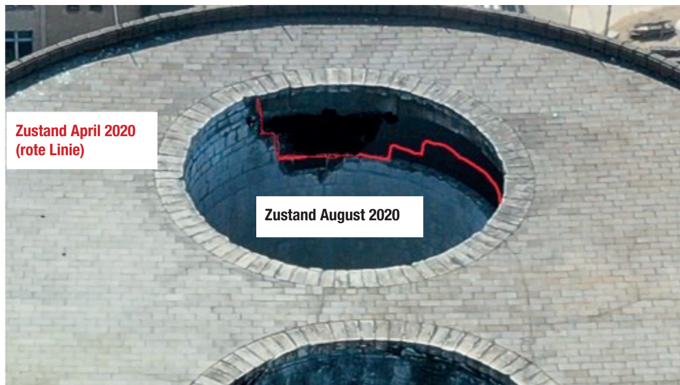
Bild 1: Schaden im Futter Linie 1 – verschiedene Zeitpunkte – Himmelsrichtung Ost oben – West unten
