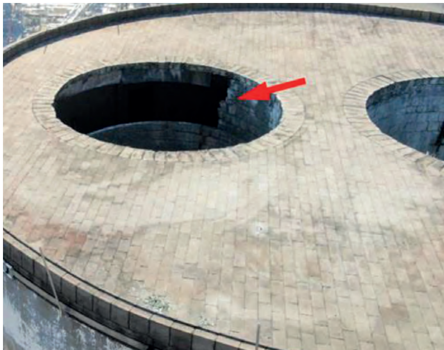
Bild 2: Schaden im Futter Linie 1 – März 2022 – kurz vor der Reparatur
