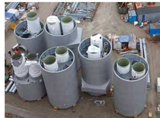
Hubeinheiten vor der Endmontage
